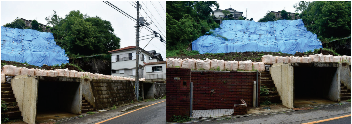
令和元年台風21号の影響による大雨で土砂崩れで2人死亡（千葉県千葉市緑区）
