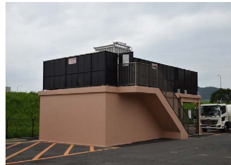
LPガスタンクは浸水しないように3mかさ上げして設置している
