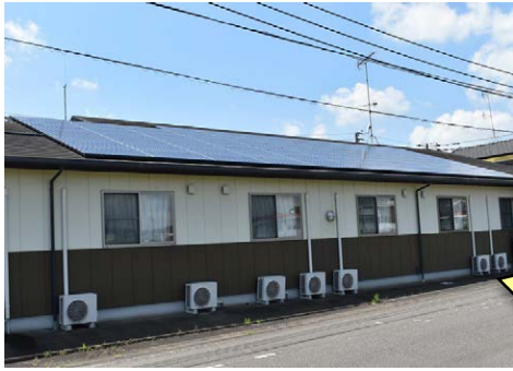
施設の屋根に設置されている太陽光発電システム
